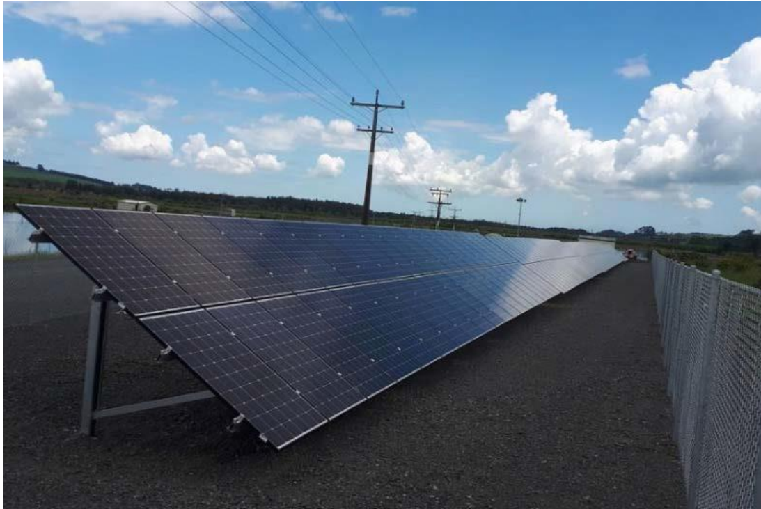
Pukekohe WWTP 122kW array
