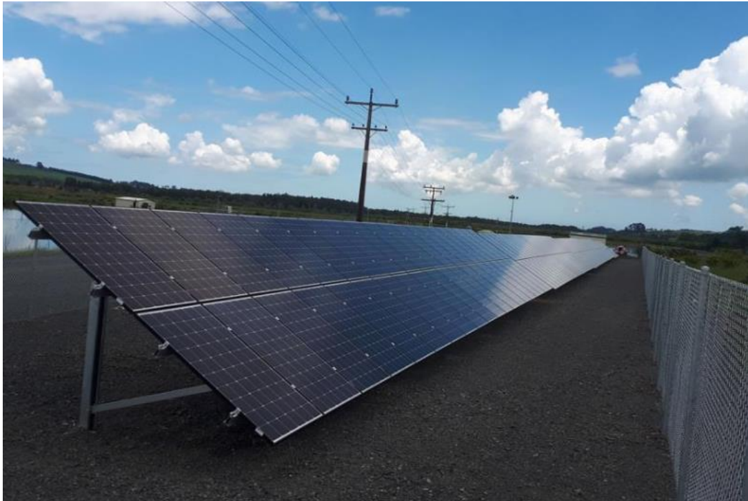
Pukekohe WWTP 122kW array
