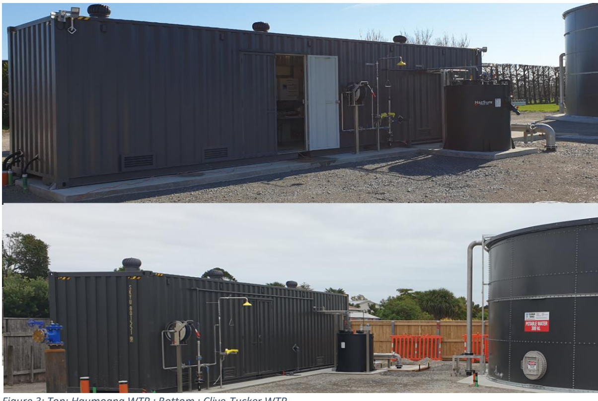
Figure 3: Top: Haumoana WTP ; Bottom : Clive-Tucker WTP
